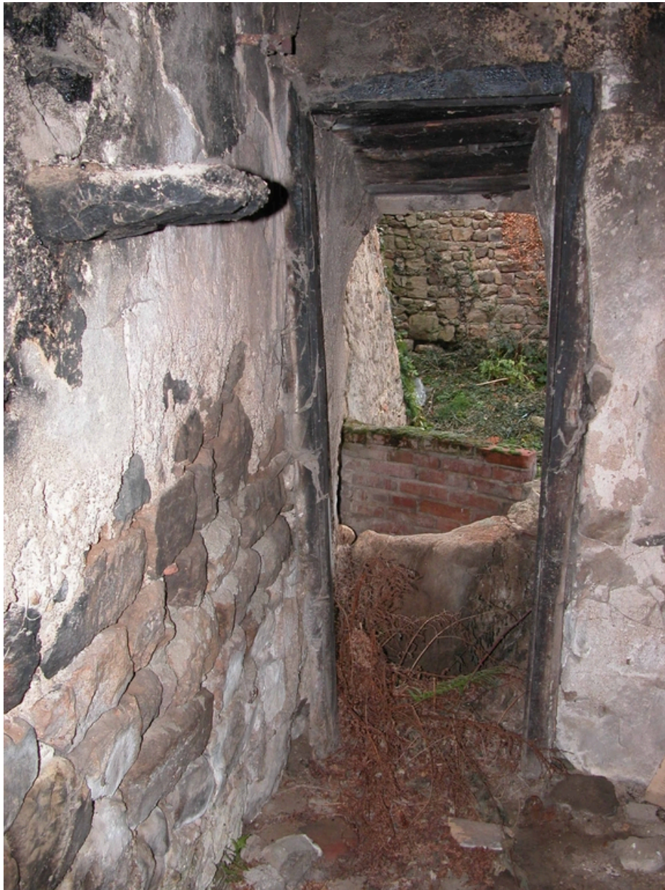
Vue de la porte aménagée dans le côté droit de la cheminée.
