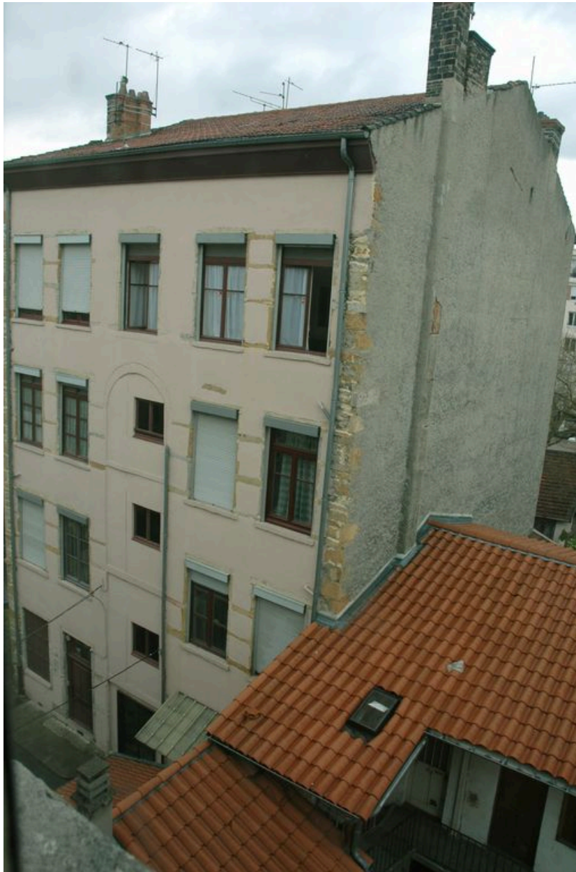
Façade ouest sur cour vue depuis une cage d'escalier au située nord
