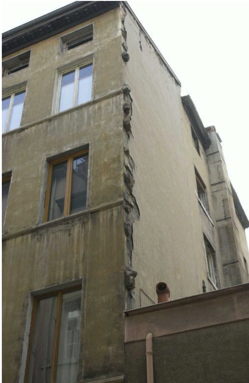
Traces d'arrachement sur le mur pignon du 3 rue des Trois-Rois
