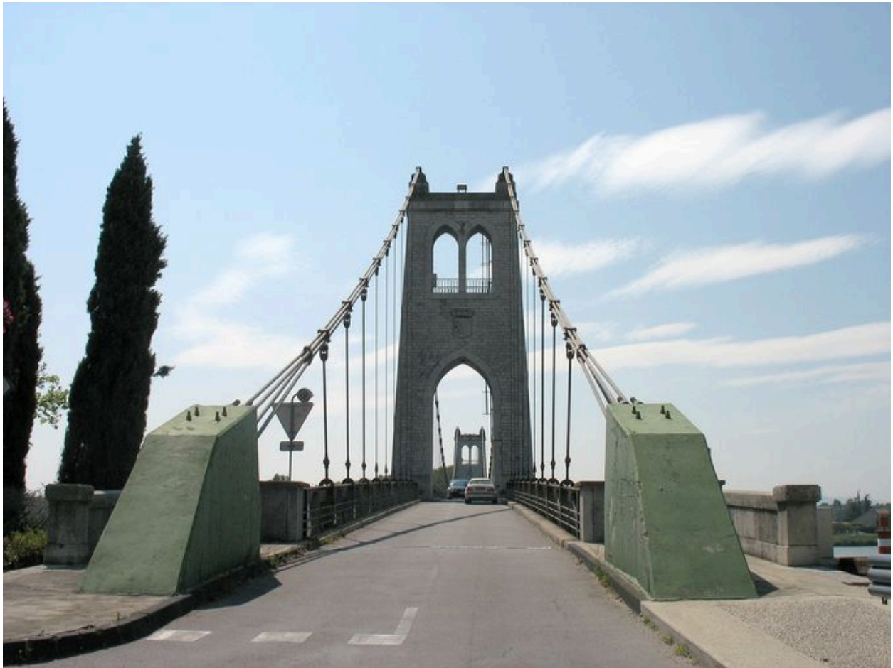
Vue de la chaussée, pylône, câbles et massifs d'ancrage côté La Voulte
