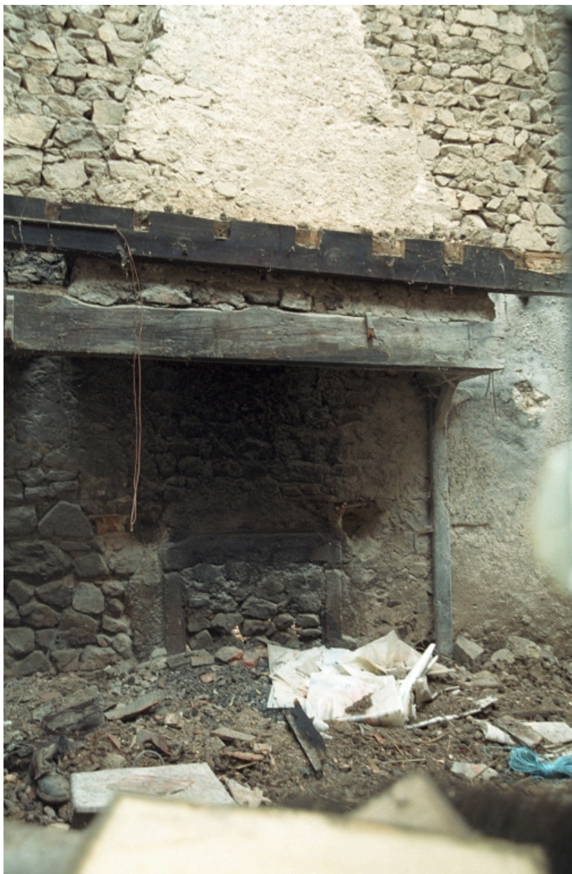
Saint-Laurent-Rochefort, la Vourgère (1987 B3 1340), type A1. Logis de la ferme, vue d'ensemble de la cheminée.
