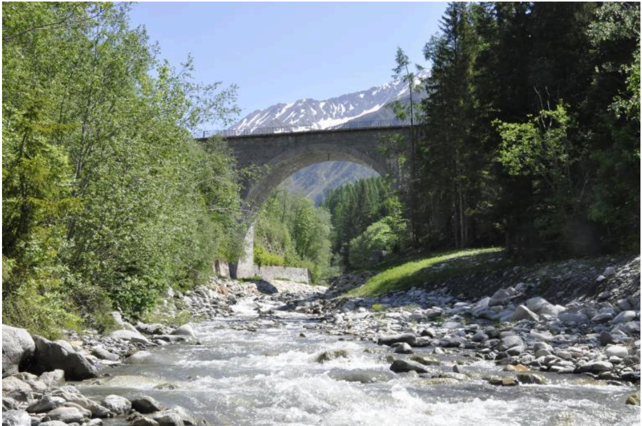
Vue de la face aval du viaduc de Mont-Roc et de son arche principale
