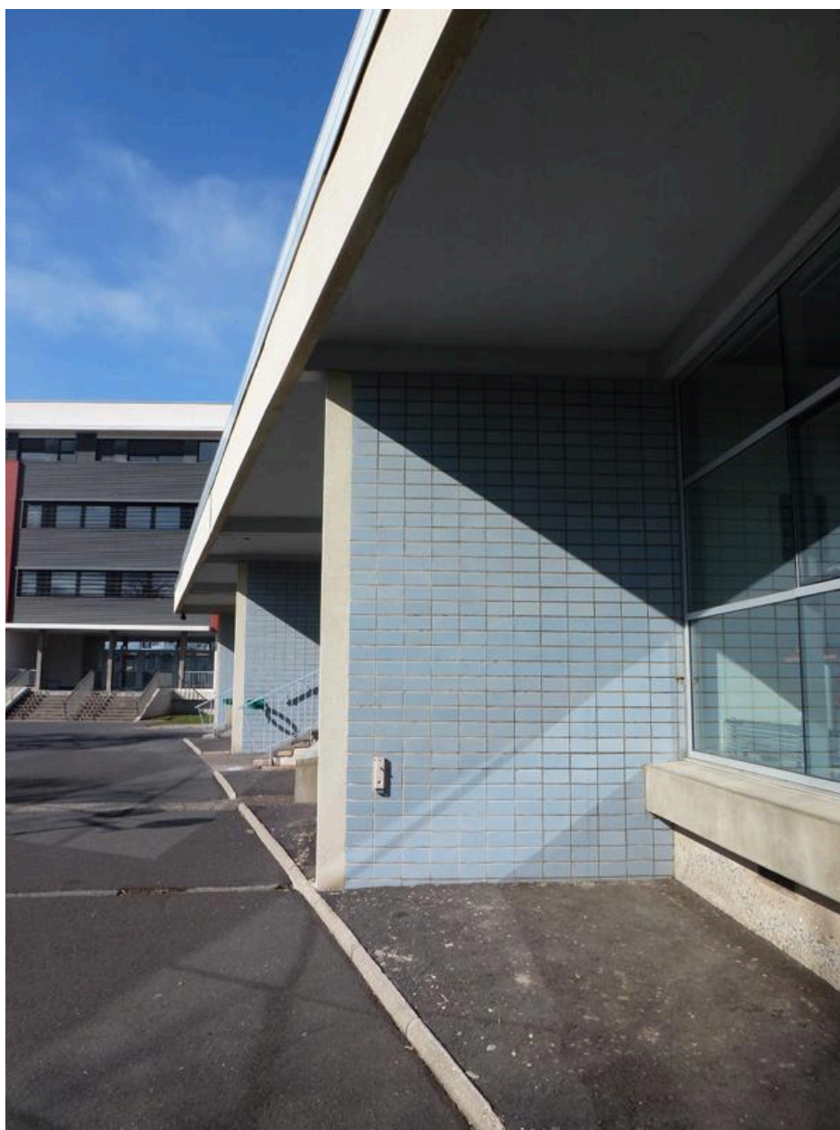
Détail de la façade sud du réfectoire sur la cour. (Photo chercheure.)
