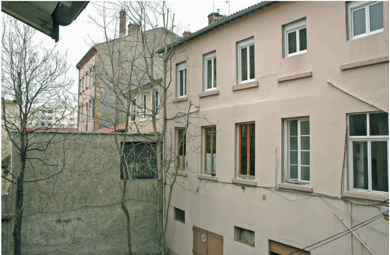
Façade ouest sur cour et mitoyenneté avec les immeubles au nord, vue depuis le sud-ouest
