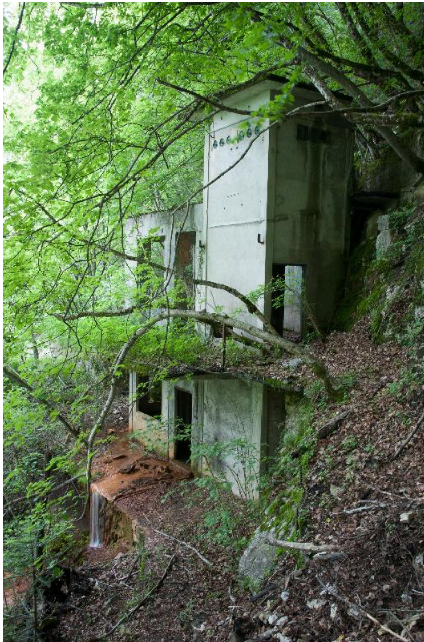
Vue du bâtiment du transformateur dans la forêt.
