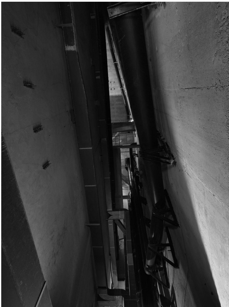
Détail arrière des cloisons du long couloir d'accès à la centrale souterraine
