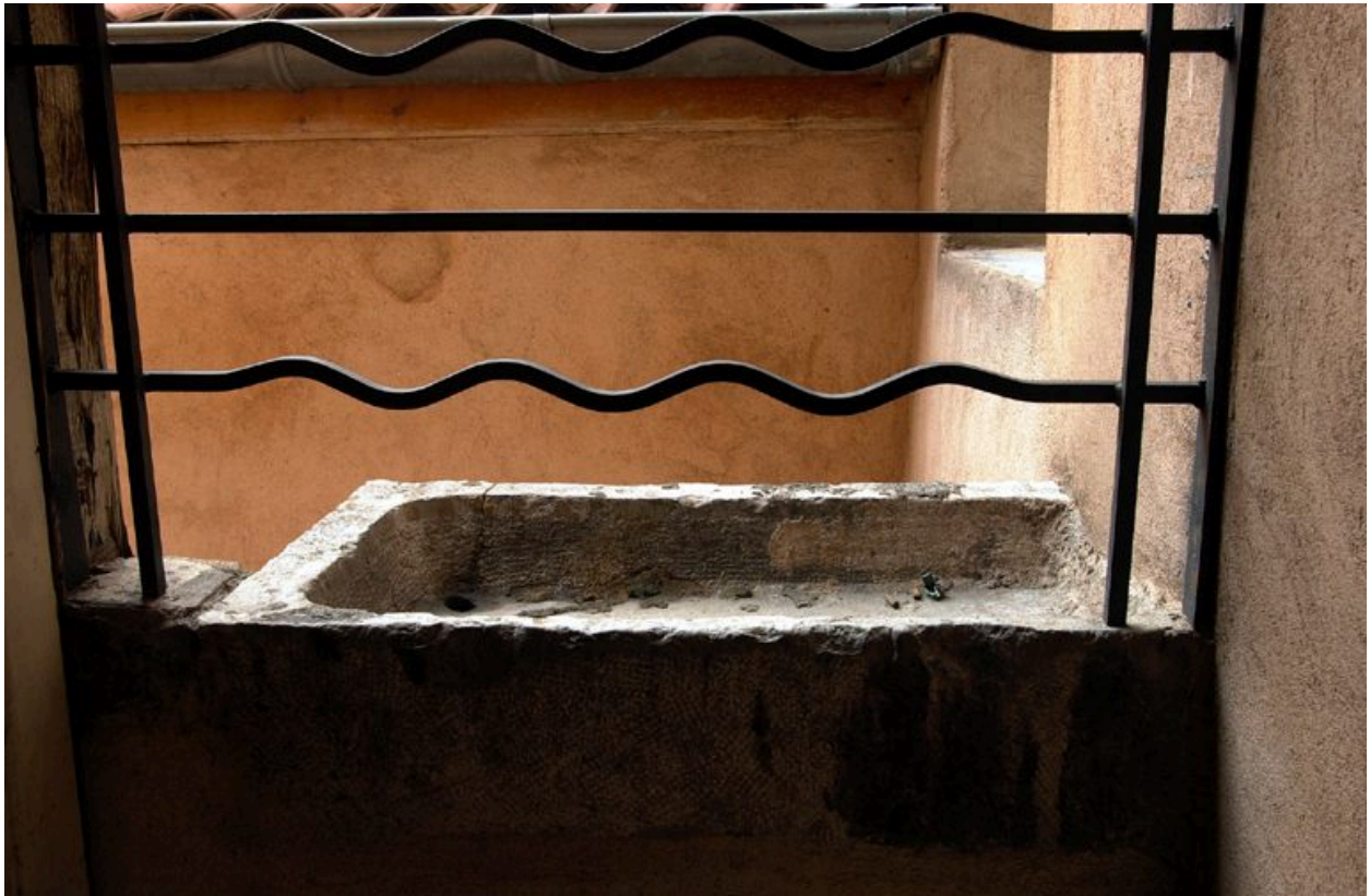
Evier en surplomb installé au dernier étage
