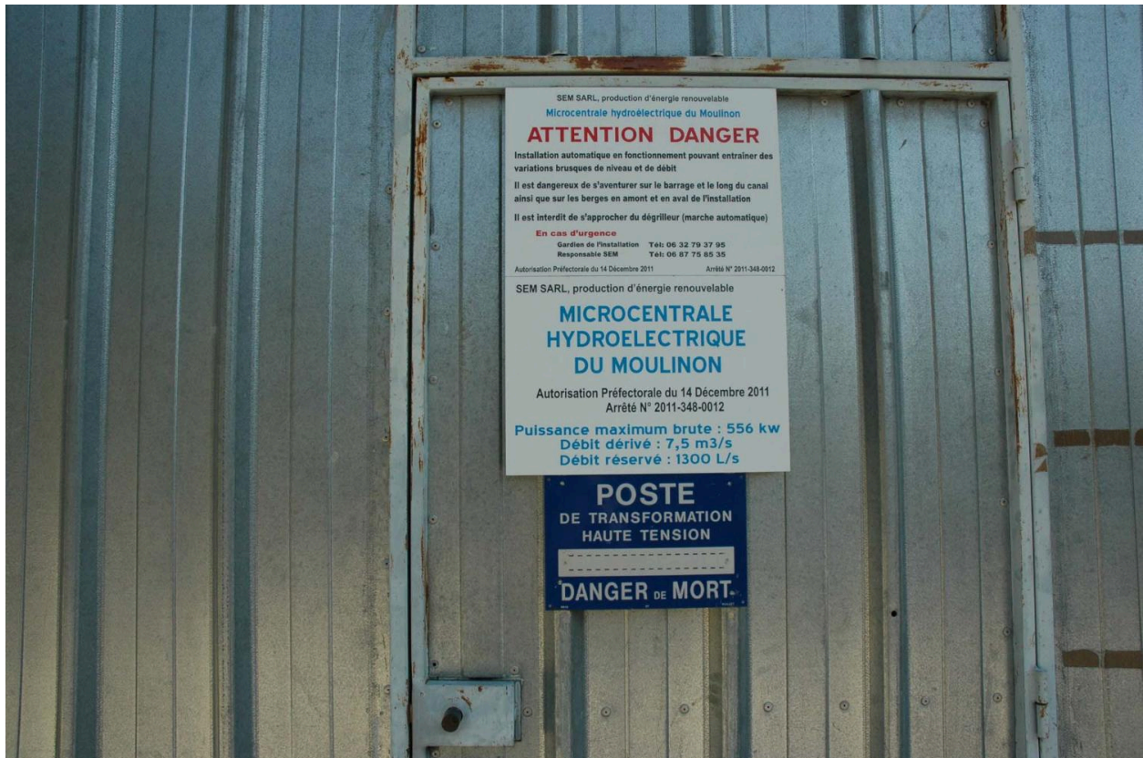
Panneau de la microcentrale hydroélectrique du Moulinon
