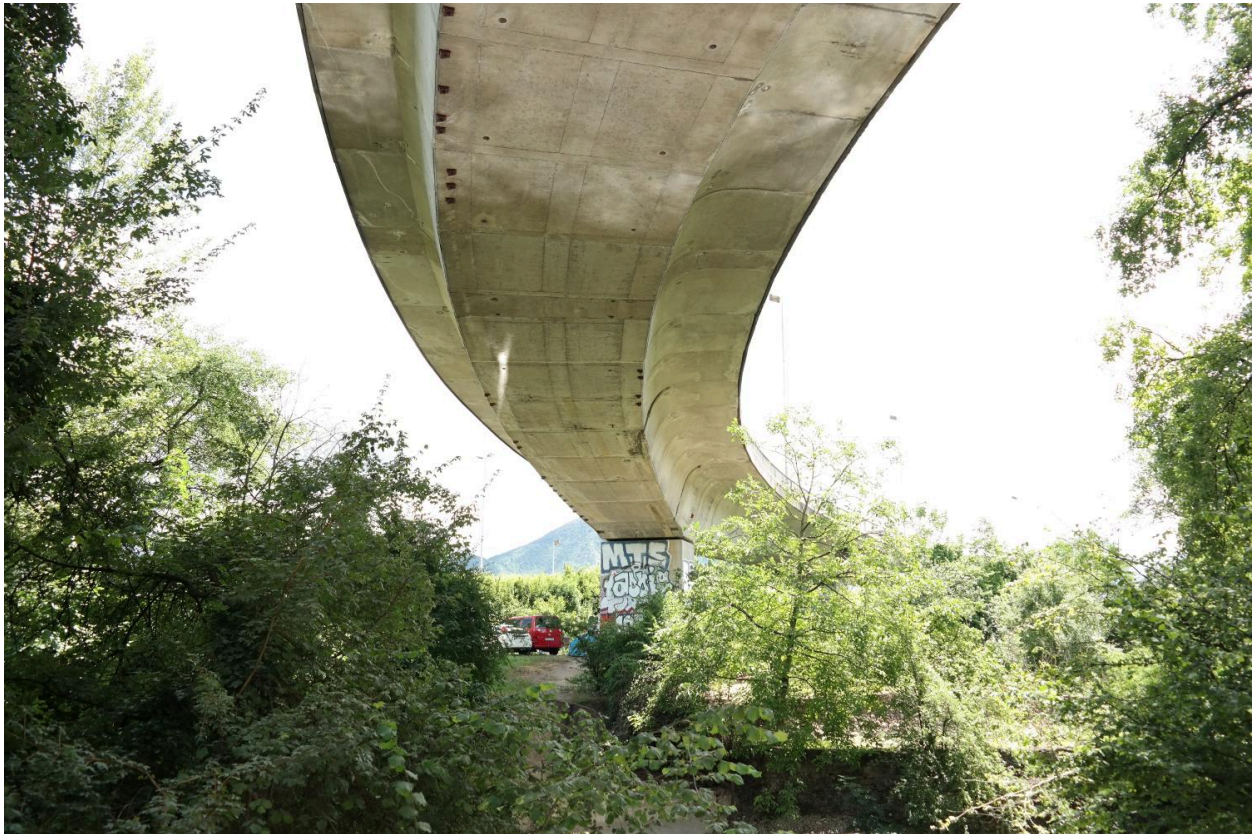
Viaduc de Cran, vue de la courbe de la bretelle de sortie
