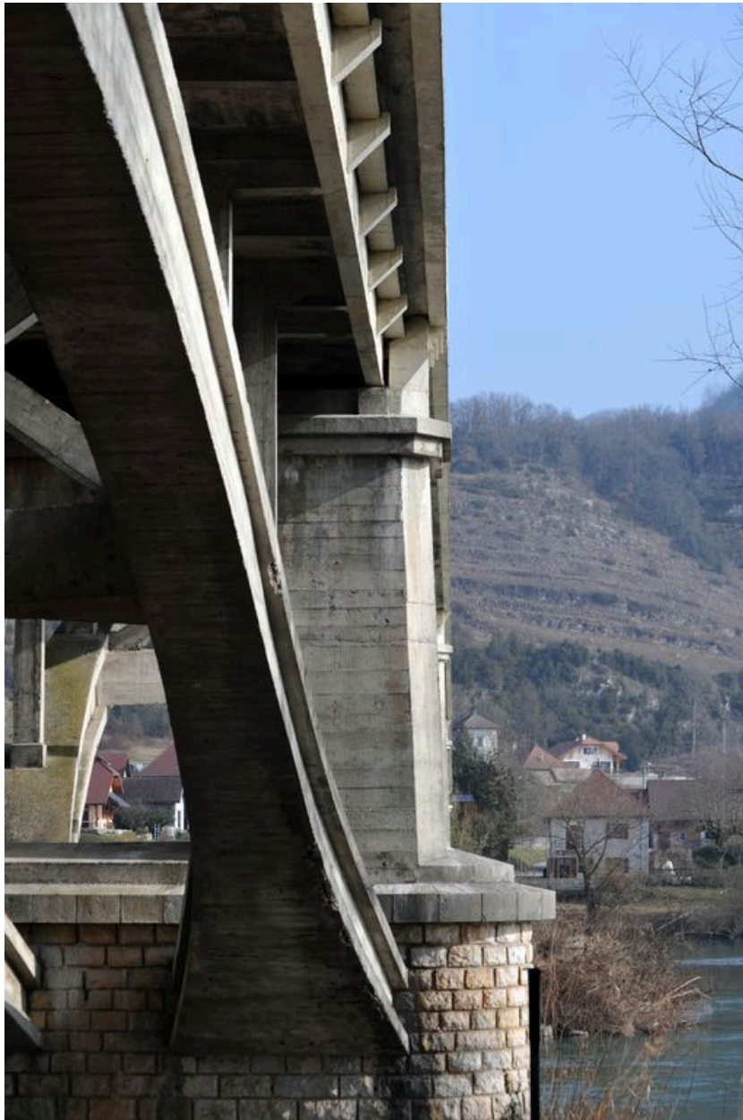
Vue partielle, de dessous, côté du tablier et pile, face aval (depuis la rive droite)
