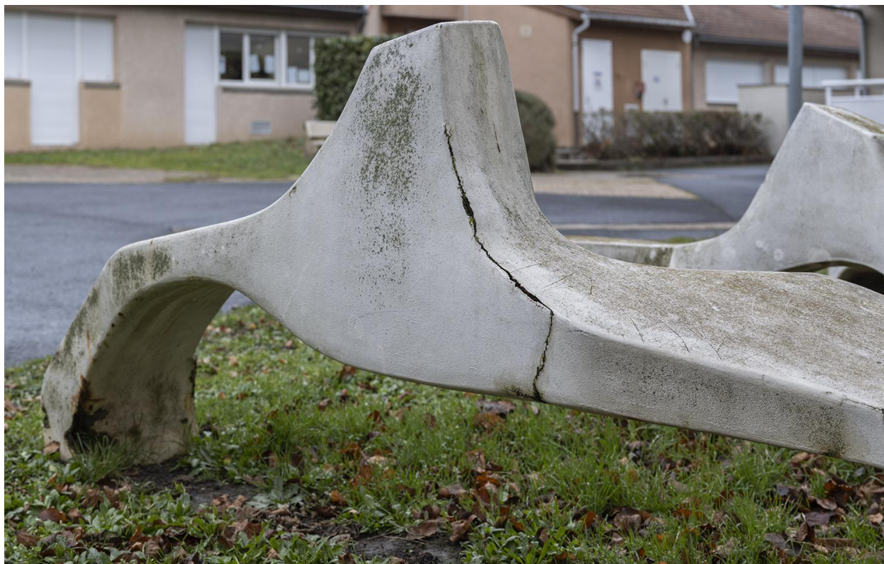
Détail : fissure dans le revêtement
