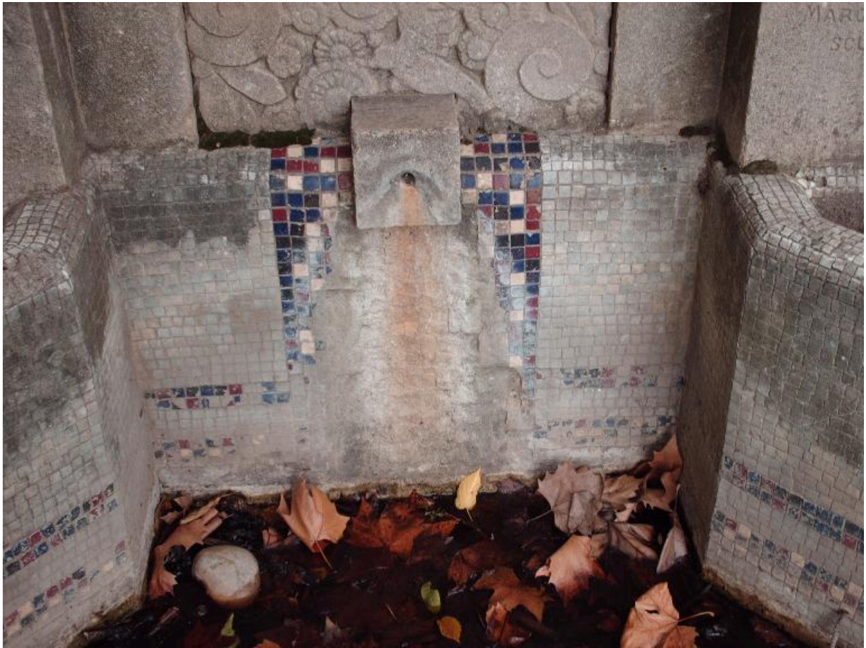
Fontaine : l'arrivée d'eau et le décor en mosaïque, en mauvais état
