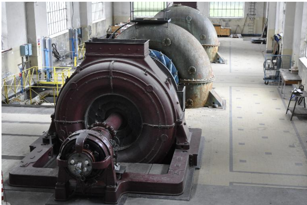
Vue des salles des machines et des groupes horizontaux
