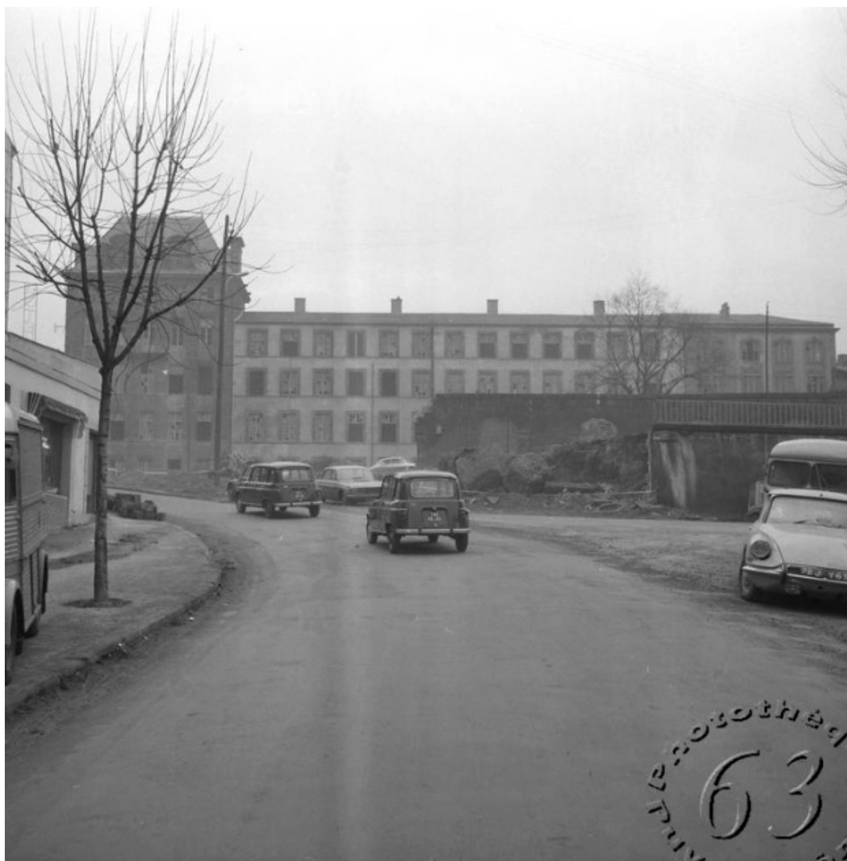
Elévation orientale du lycée et arcades clôturant la cour en cours de démolition, fin 1966 (Phot. R. Giffoni, AD Puy-de-Dôme, 616 Fi 4550)
