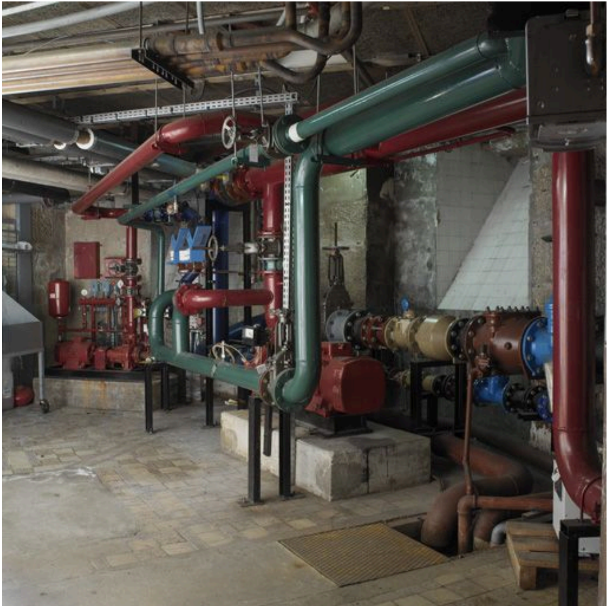
Sous-sol rue de la République, salle des machines : la machine Sprinkler
