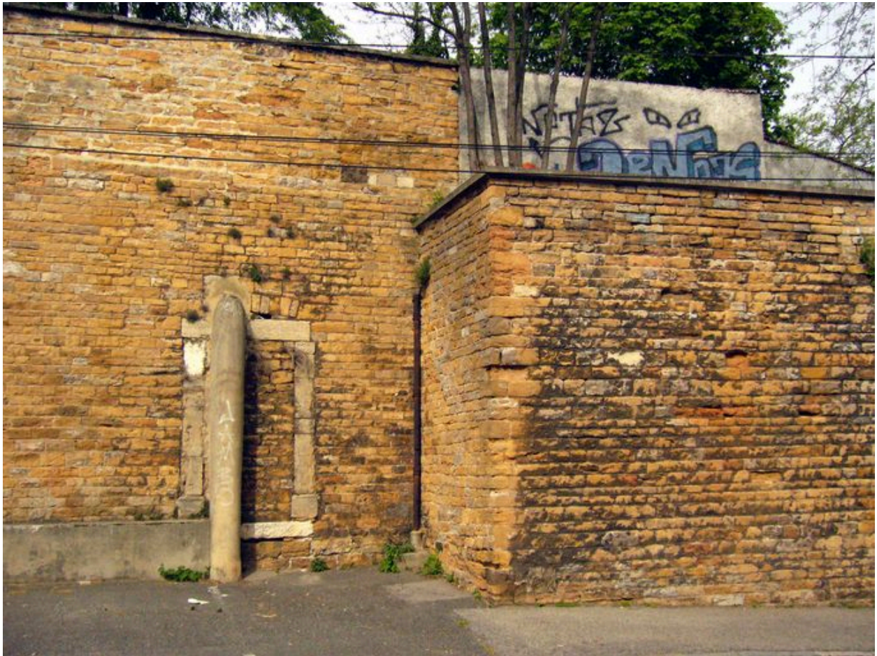
Terrasse des pavillons du télégraphe, avec l'ancienne porte des Minimes, aujourd'hui murée
