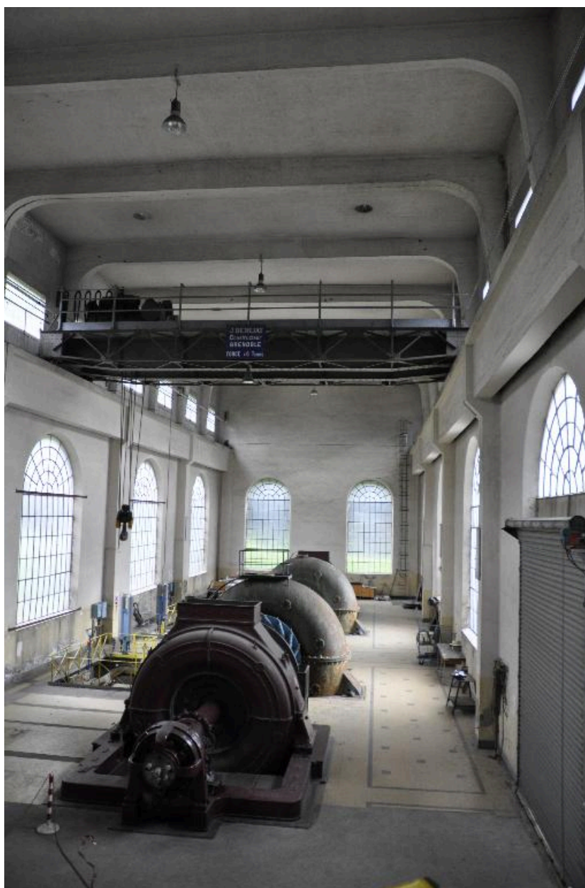
Vue intérieure de la salle des machines
