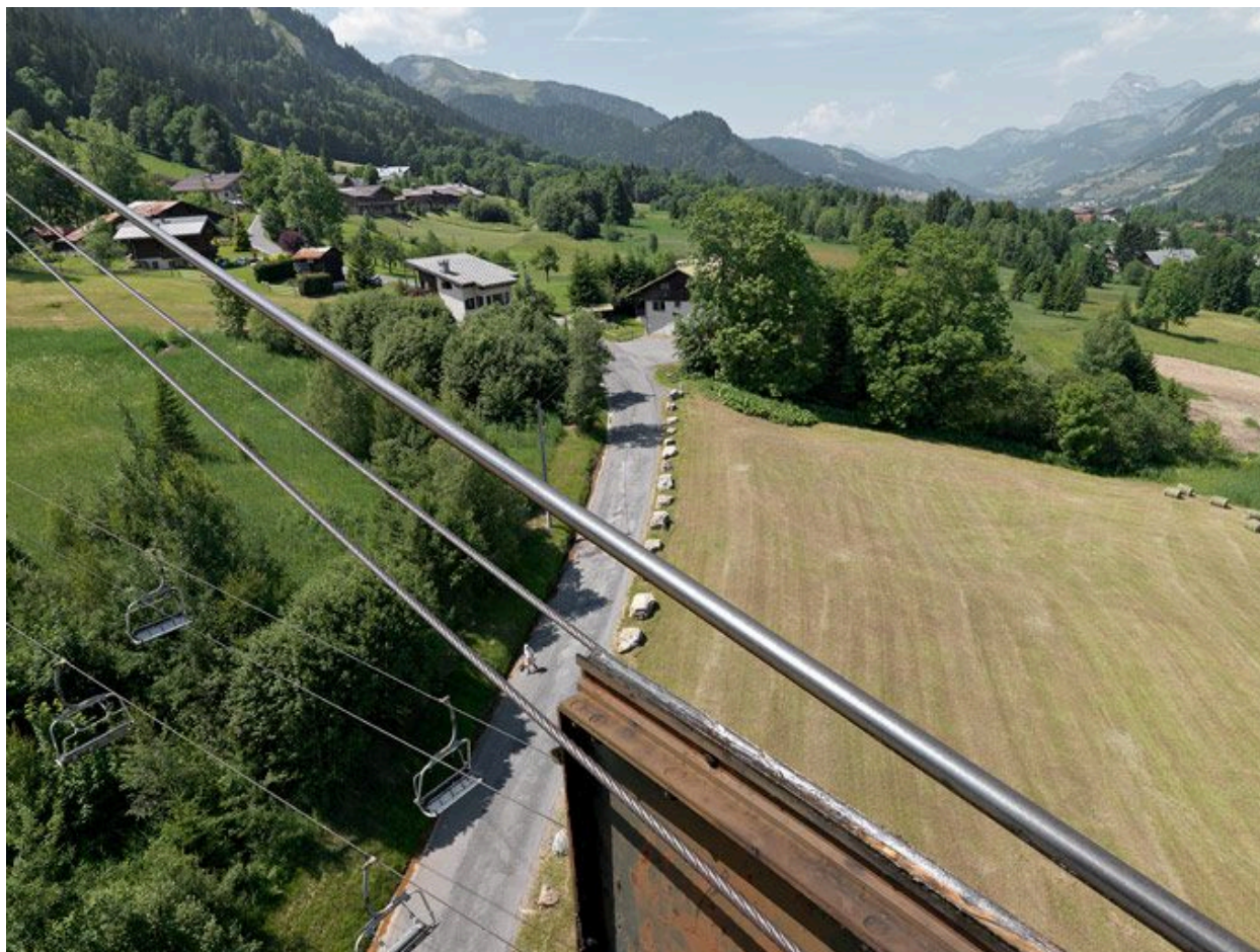
Détail du câble
