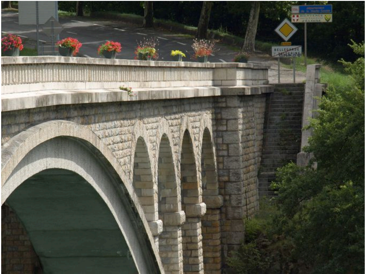
Vue partielle, de côté, moitié de l'arche et escalier de la culée gauche, face aval (depuis la rive droite)
