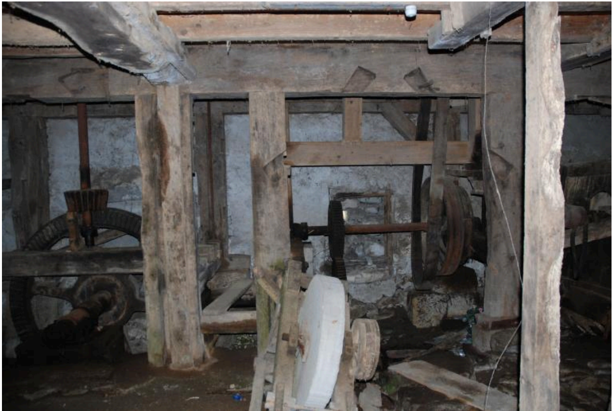
Vue intérieure de l'étage de soubassement, partie nord-est : système d'entraînement de la meule, axe de la roue à aubes.
