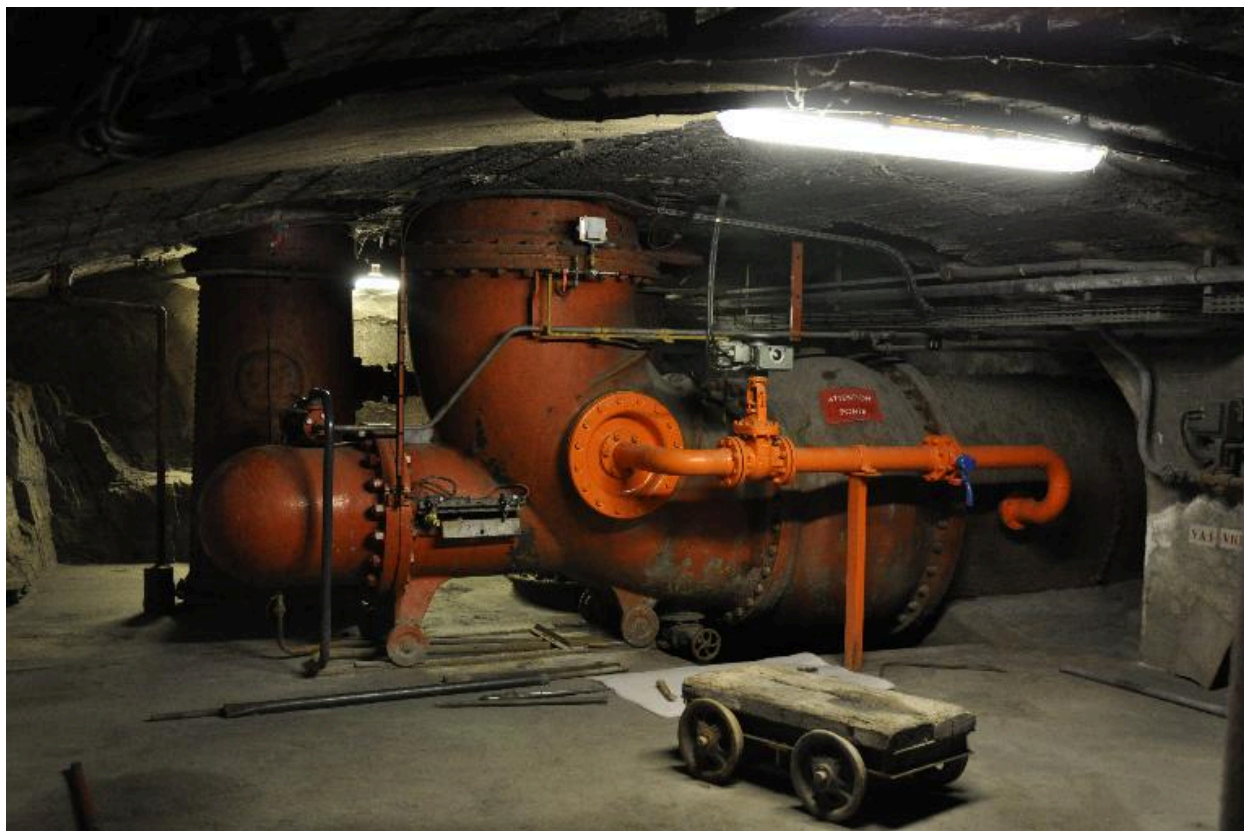
Vanne de pied, vanne autoclave : centrale de Livet
