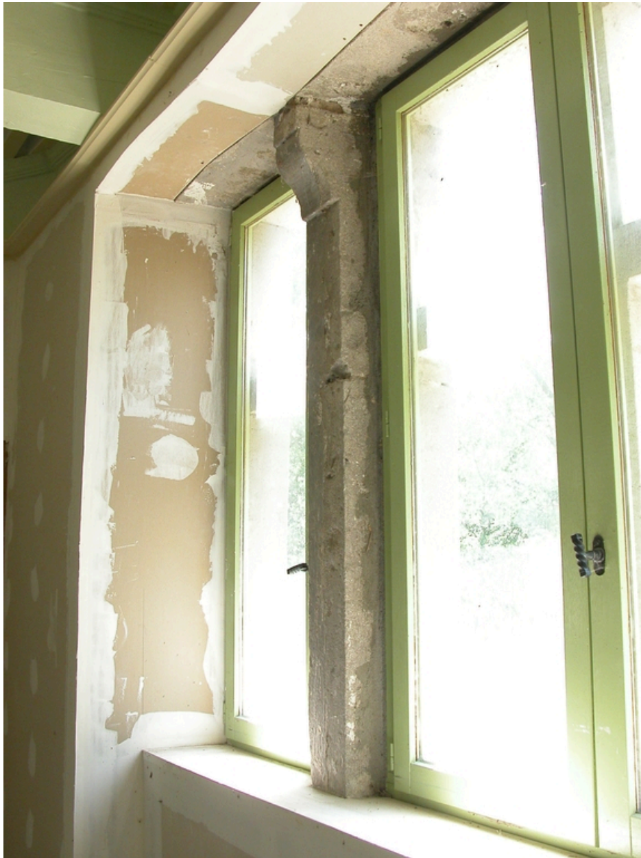
Vue intérieure de la salle ouest du rez-de-chaussée surélevé : détail de la fenêtre (piédroit intermédiaire à console).
