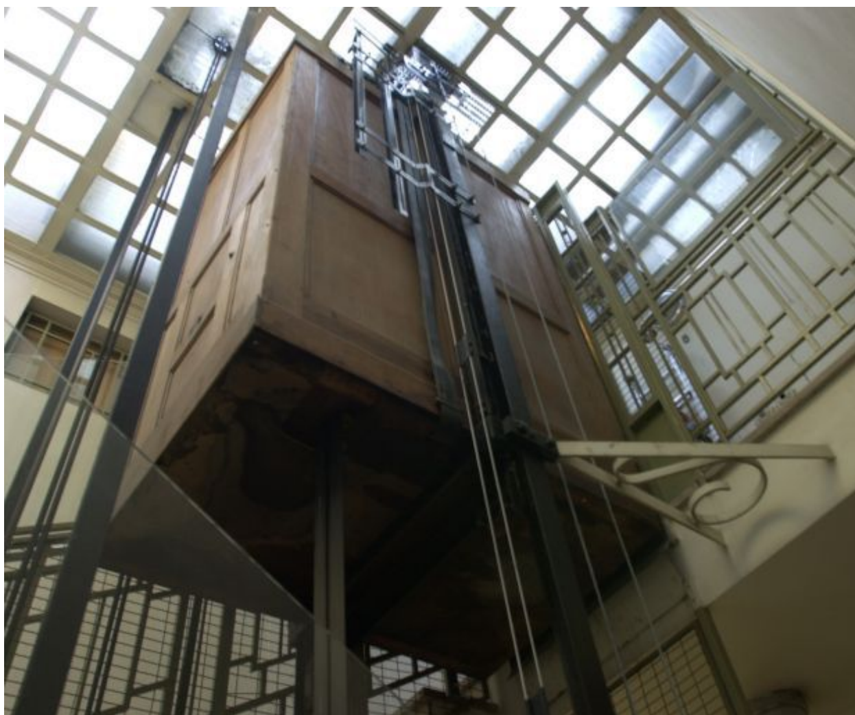
Ascenseur vu de dessous
