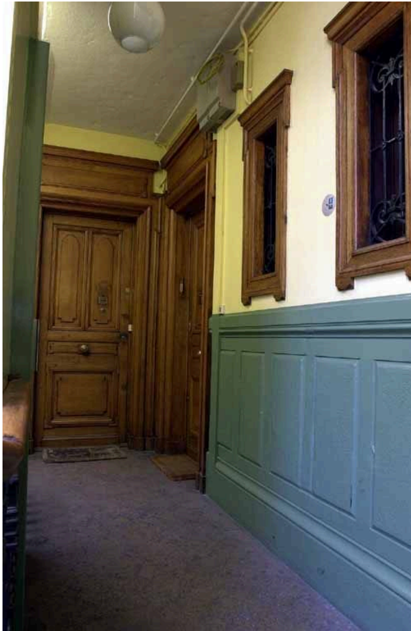
Portes palières et fenêtres de second jour
