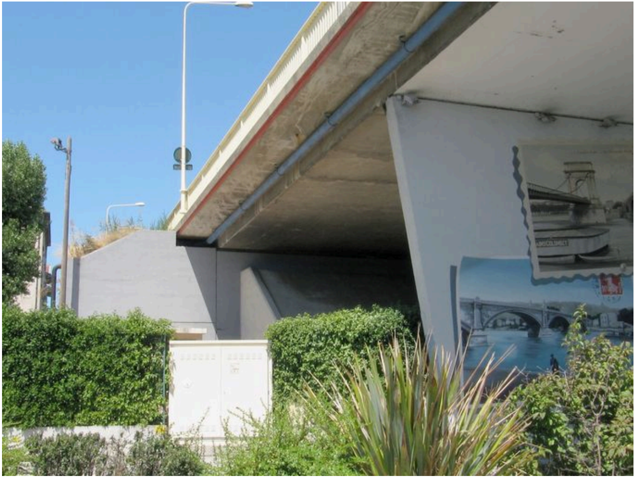
Travée de rive droite, face aval, vue partielle : jonction avec le tablier (depuis la rive droite)
