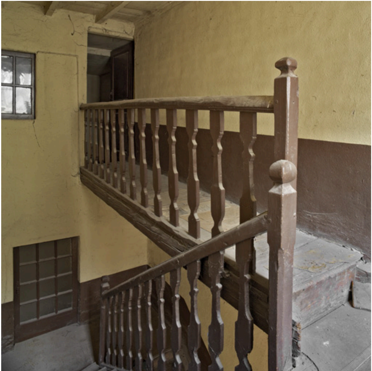
Rampe d'appui en bois découpé, 3e volée et palier de l'étage en surcroît, 19e siècle.
