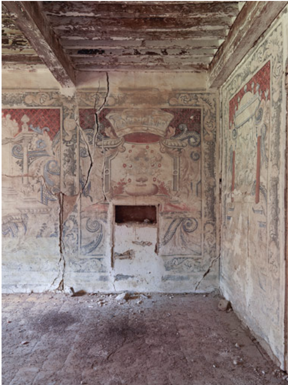
Mur nord, panneau de droite (endommagé par le percement d'un placard).
