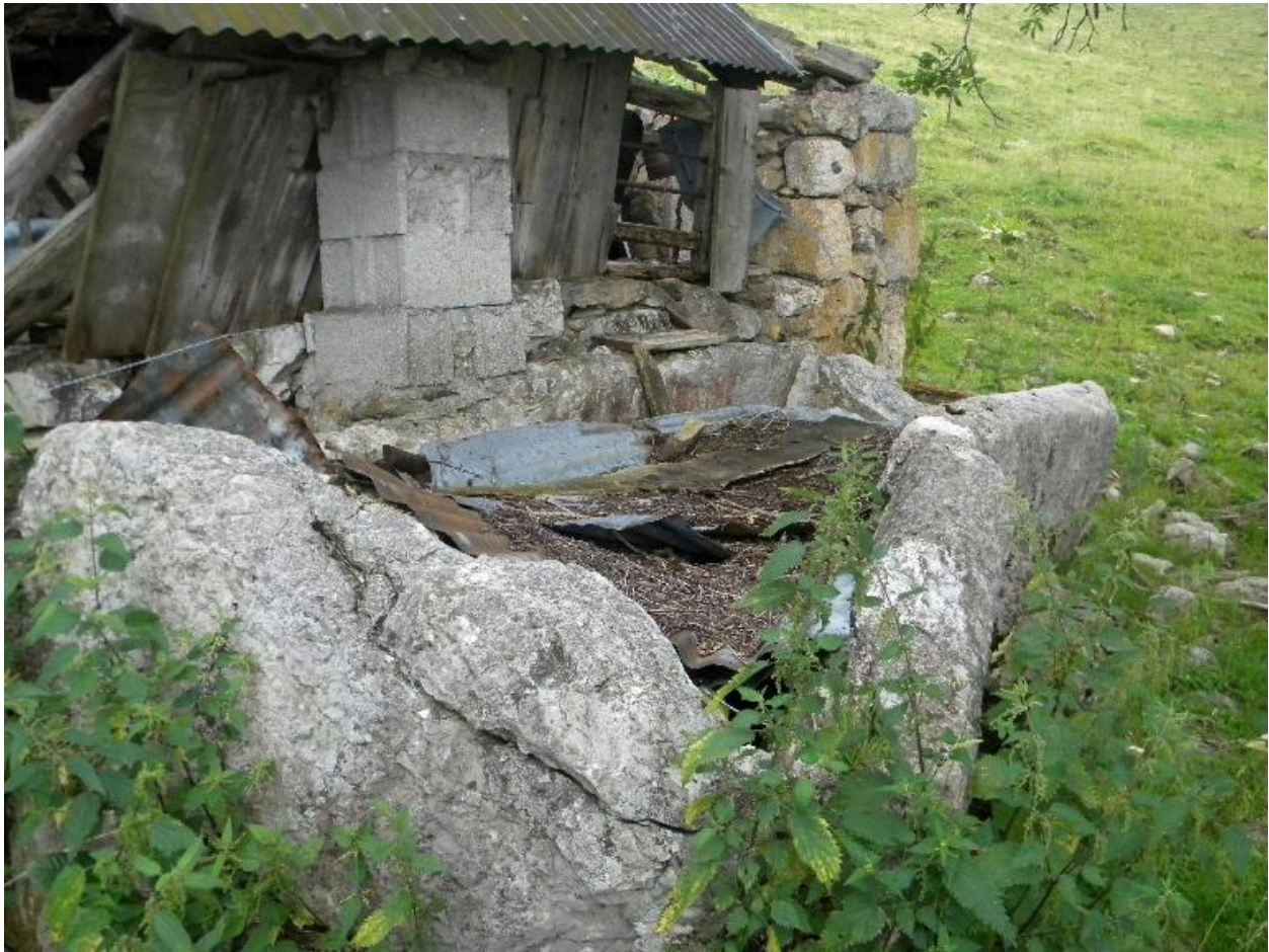
Détail du bassin cassé devant les ruines du bâtiment.
