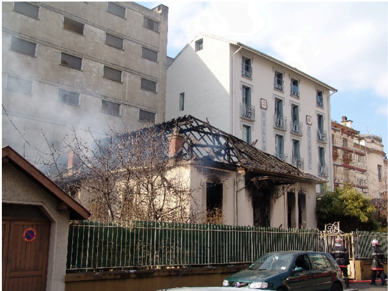
Vue générale de la maison incendiée
