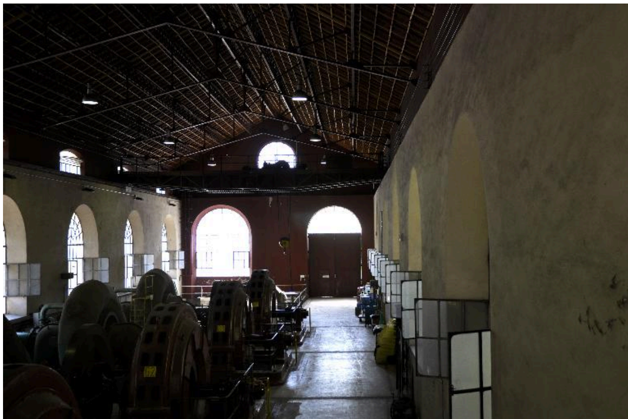
Vue de la salle des machines
