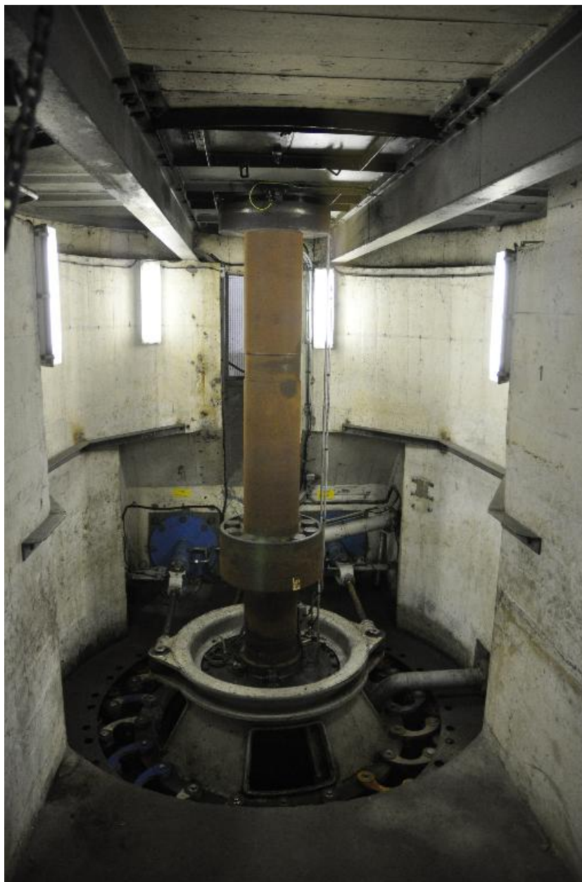
détail d'un axe vertical d'un groupe vertical
