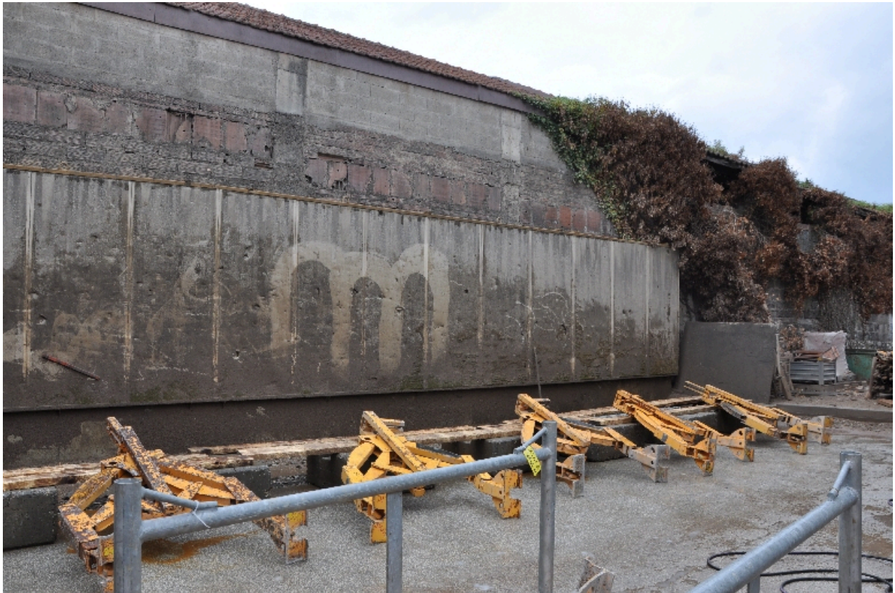
Aire de lavage
