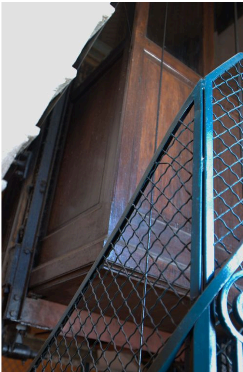
Ascenseur, cabine, vue arrière, par en-dessous
