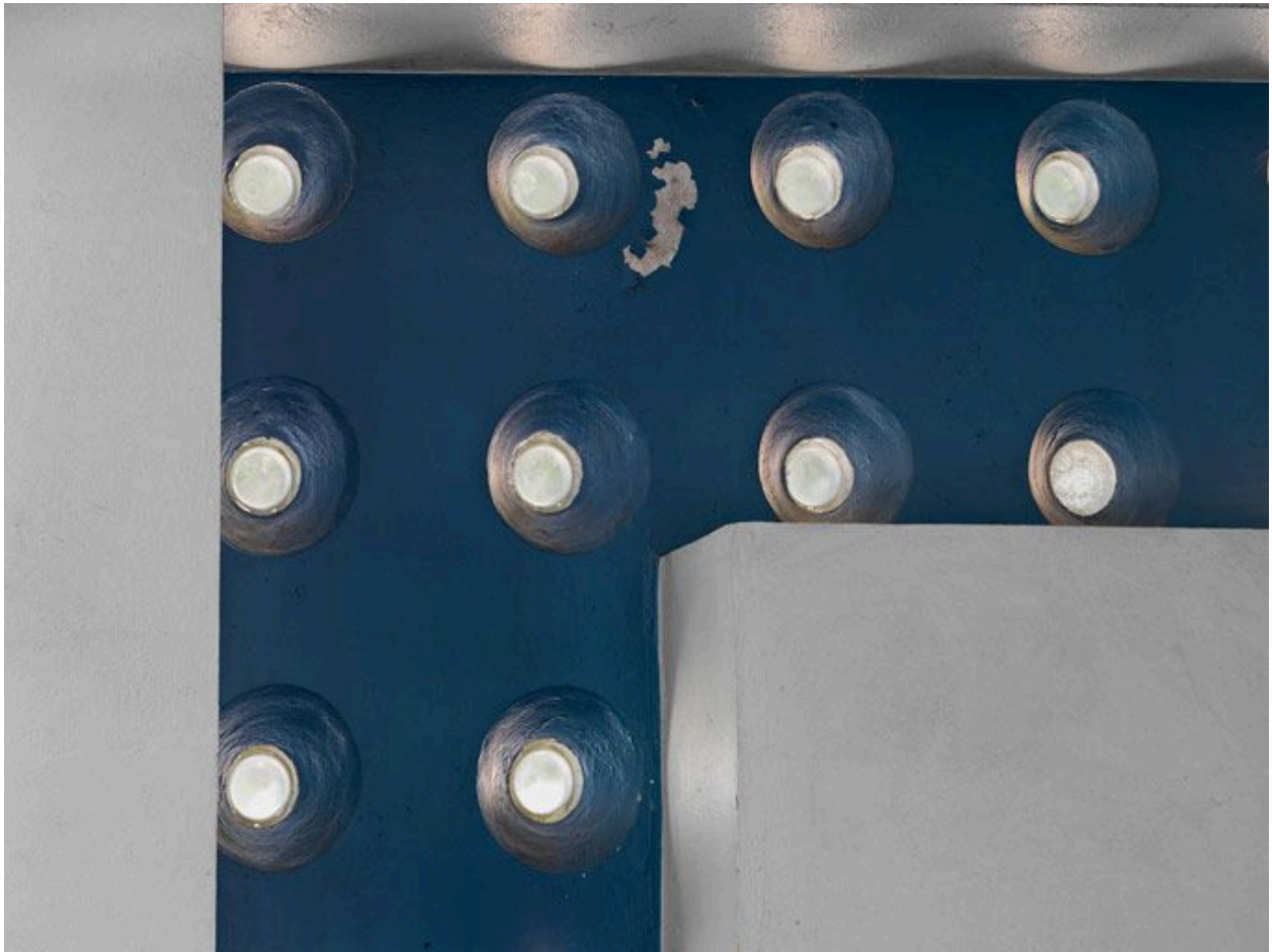
Détail du système d'éclairage au niveau de l'entrée des bureaux (niveau du quai).
