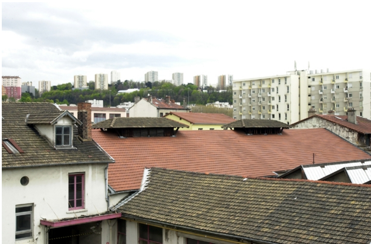
Aérateurs des ateliers ouest, donnant sur la rue des Tuileries
