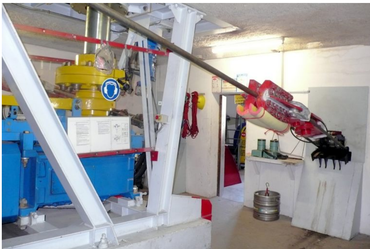
Gare inférieure. Le système d'accrochage des câbles
