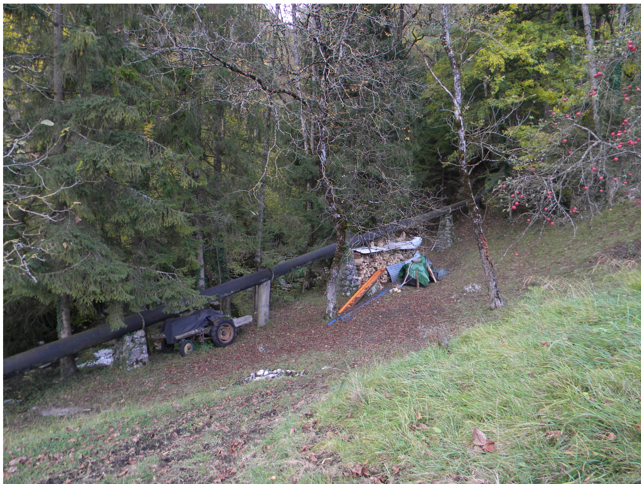
Vue de la conduite forcée.
