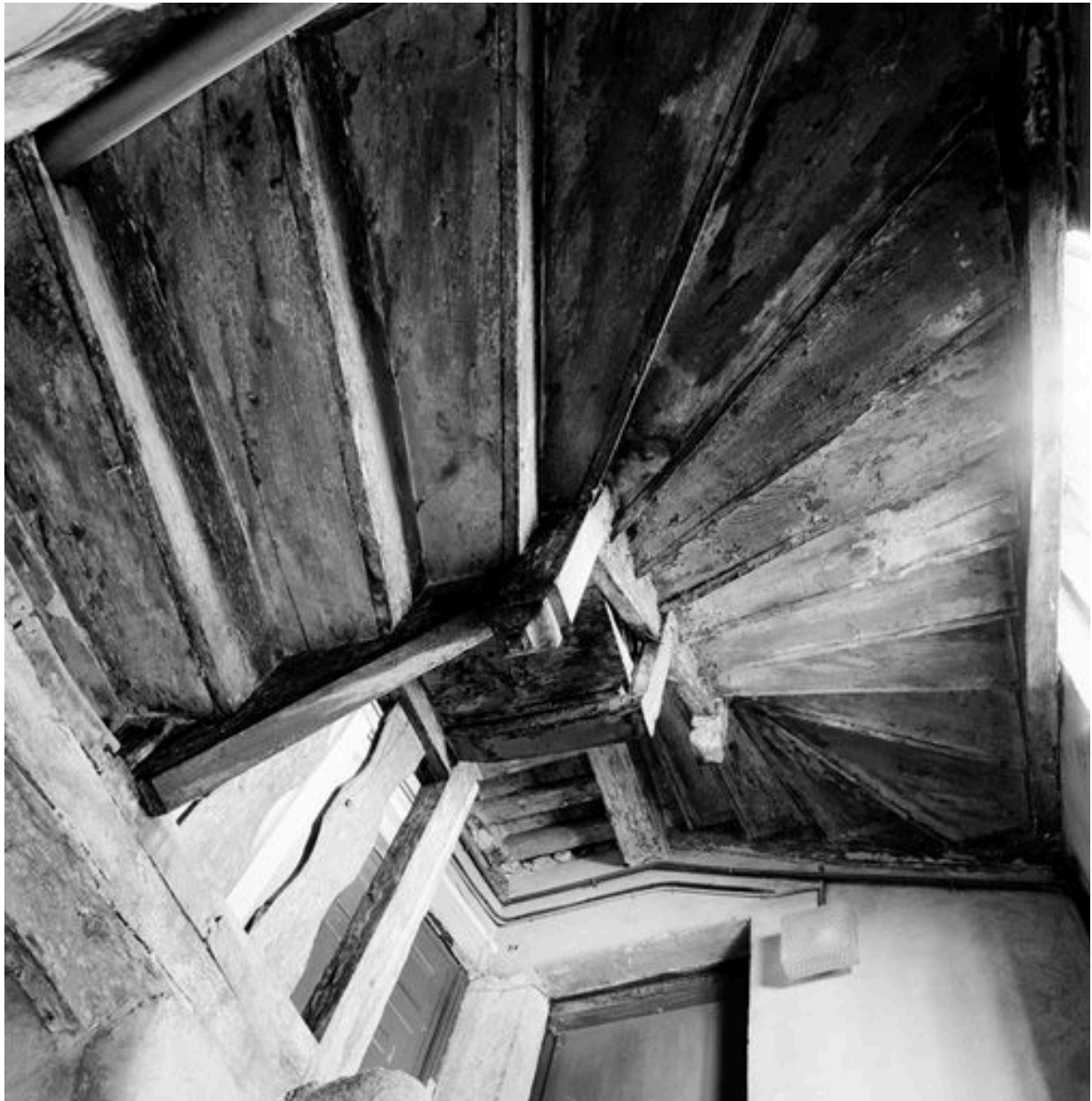
Petit escalier en bois desservant la pièce au sommet du pavillon de l'escalier
