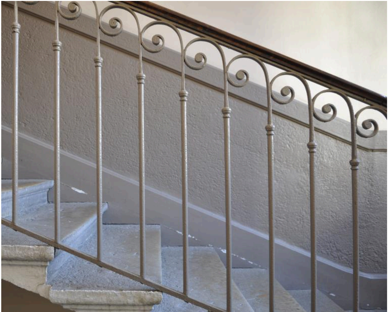
Immeuble sur rue : le garde-corps de l'escalier
