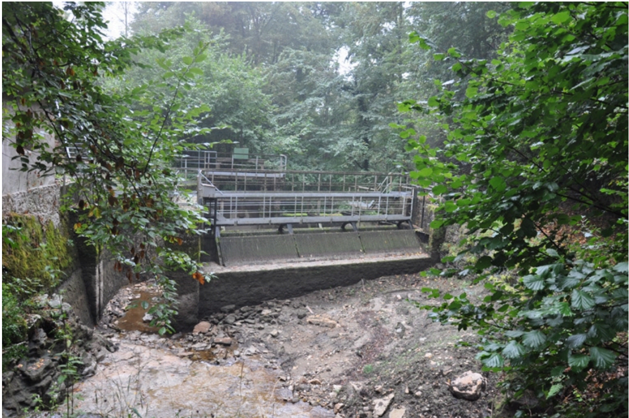
Vue de la prise d'eau sur le ruisseau du Rondelet.
