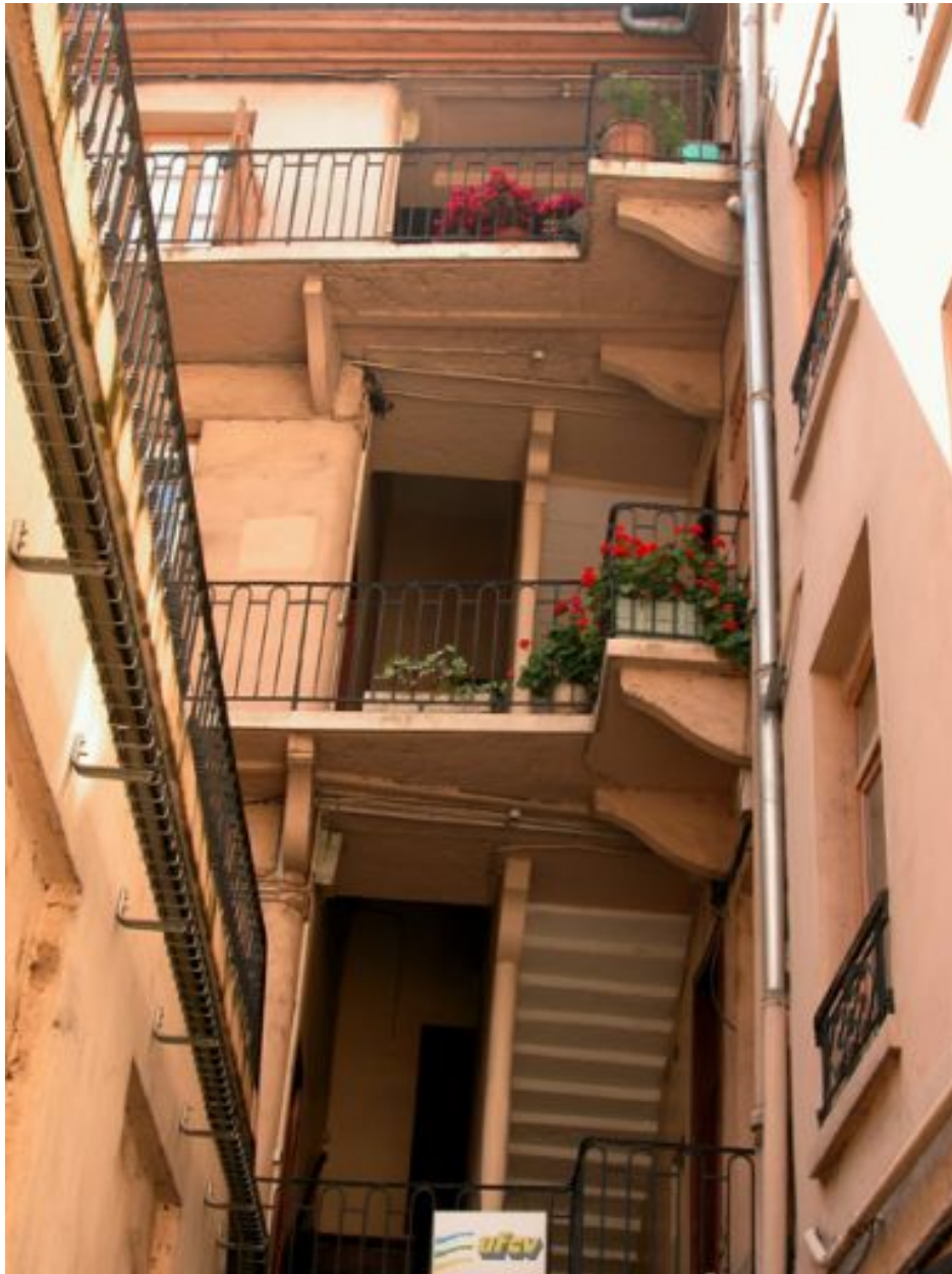
Bâtiment 3 vu depuis la cour III, élévation des niveaux 2 à 4 de la cage d'escalier
