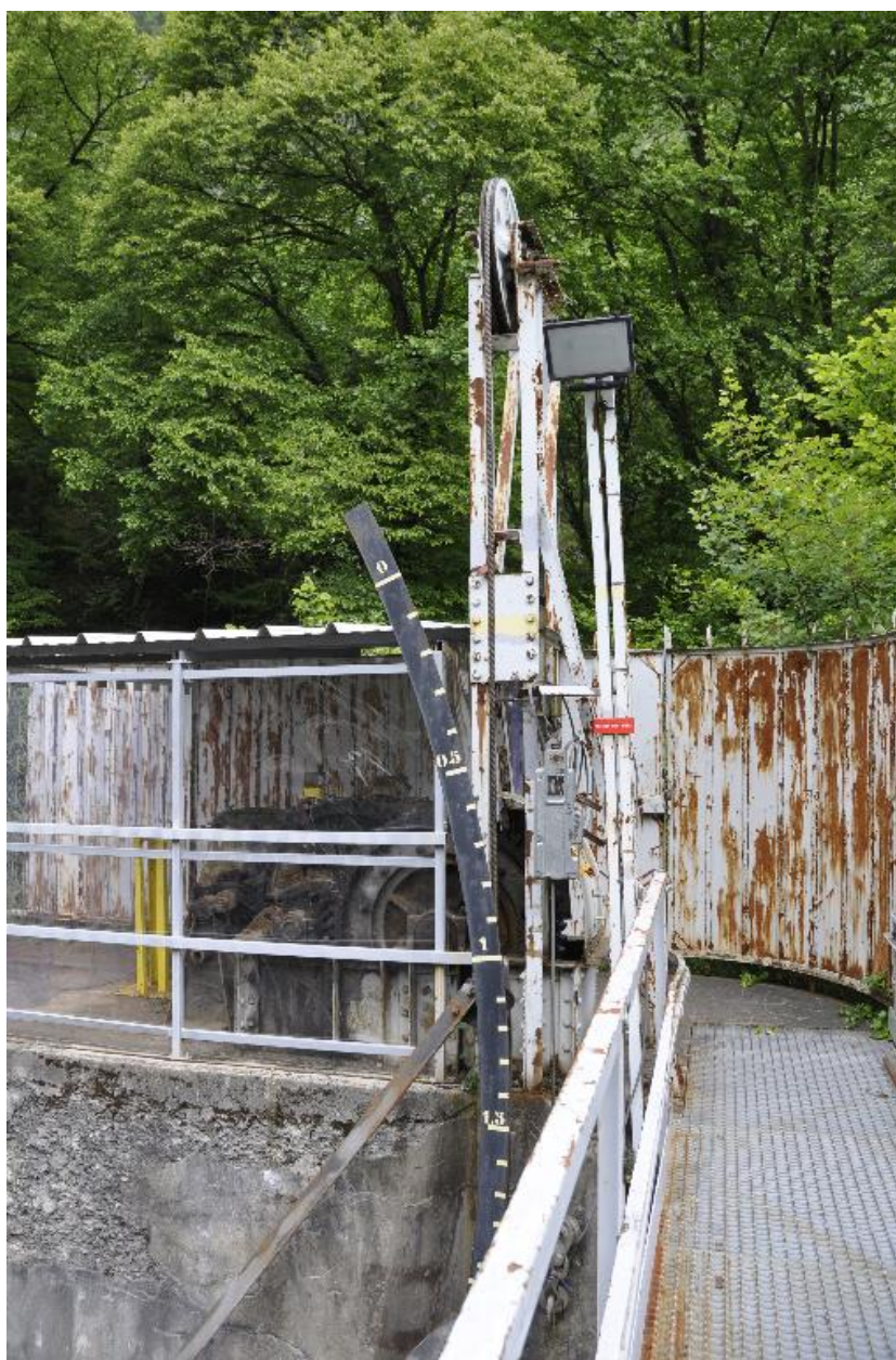
Détail de mesure du niveau de l'eau du barrage
