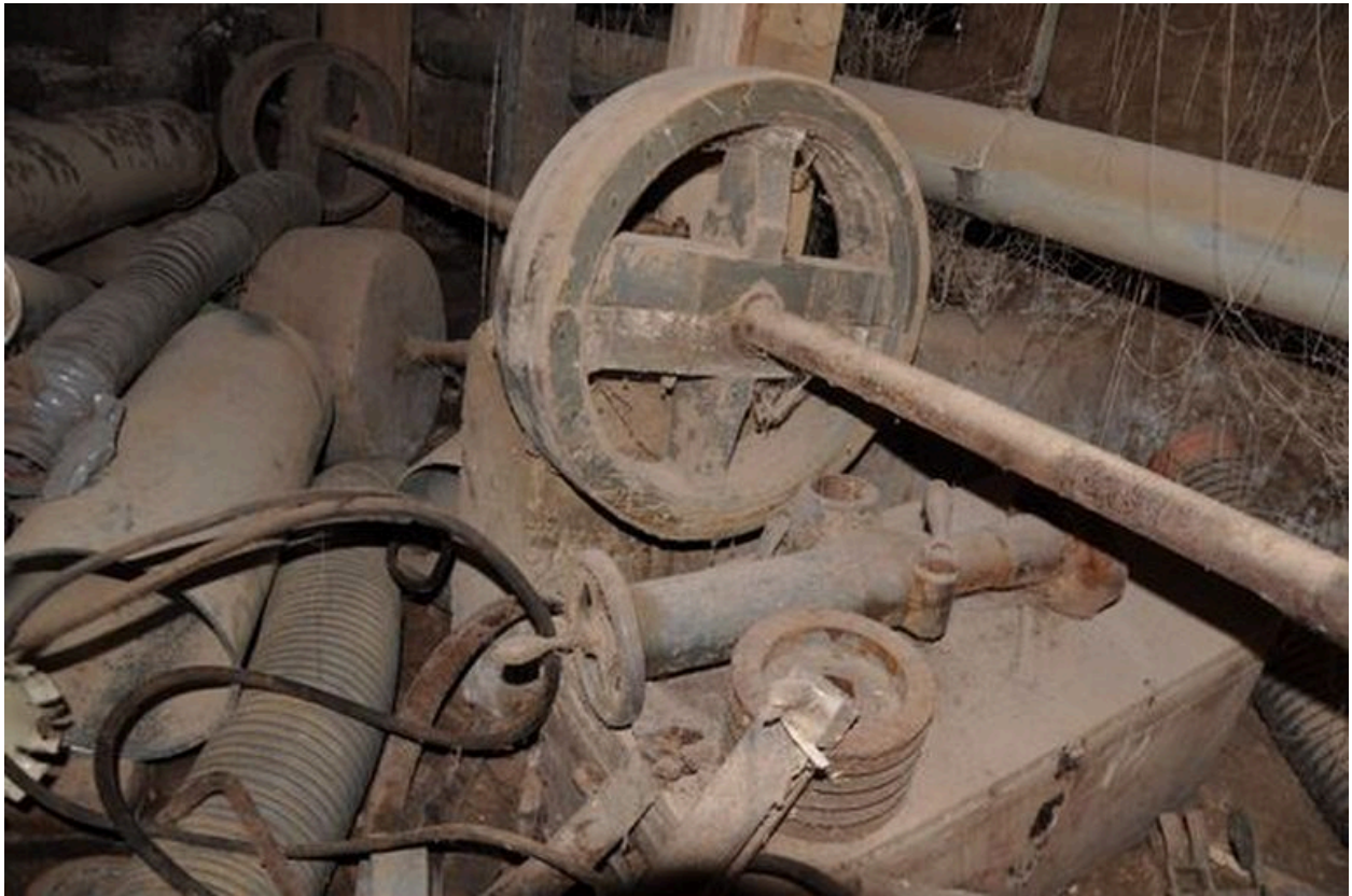
Engrenages de la battante située au sous-sol
