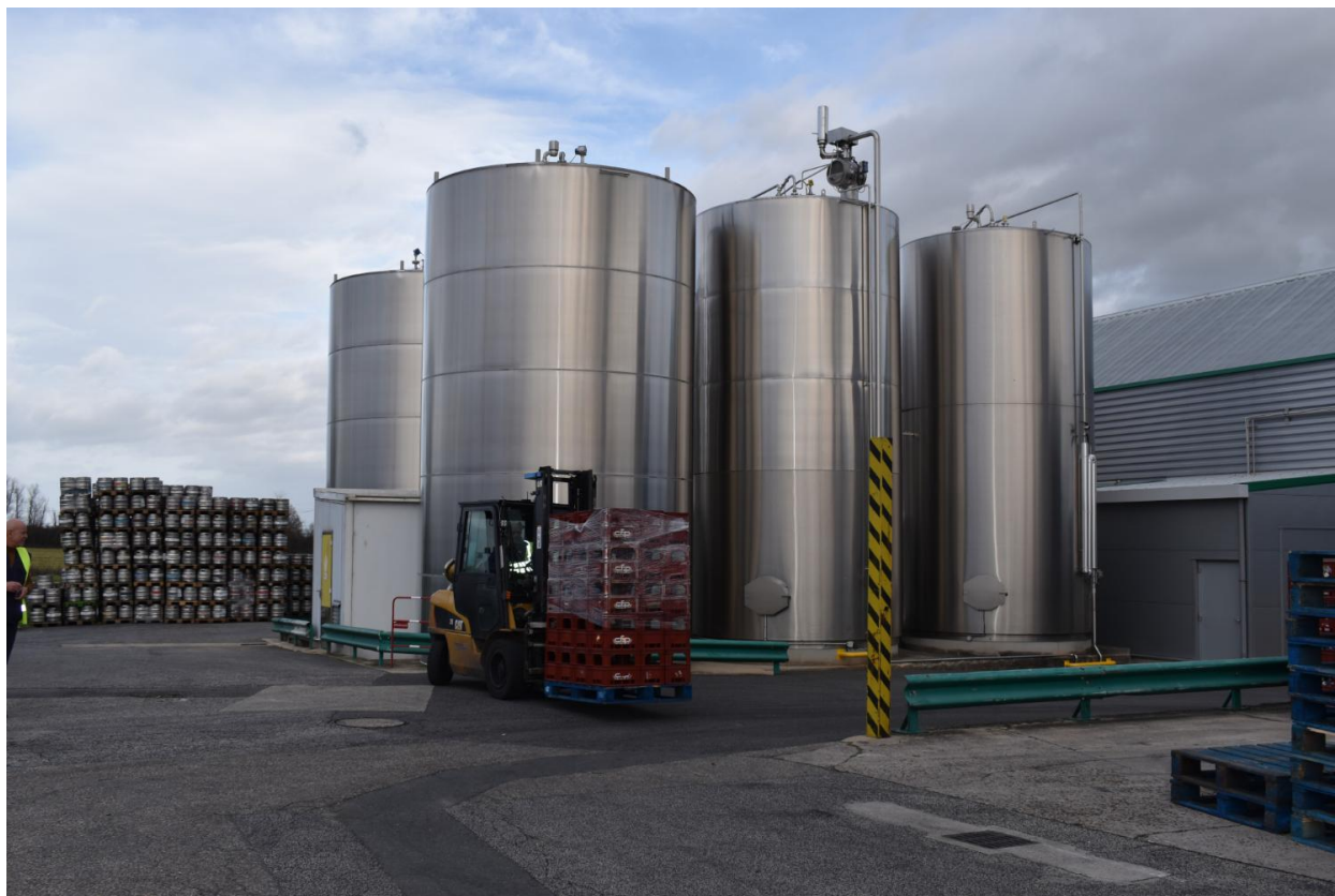
Vue des cuves de stockage extérieur
