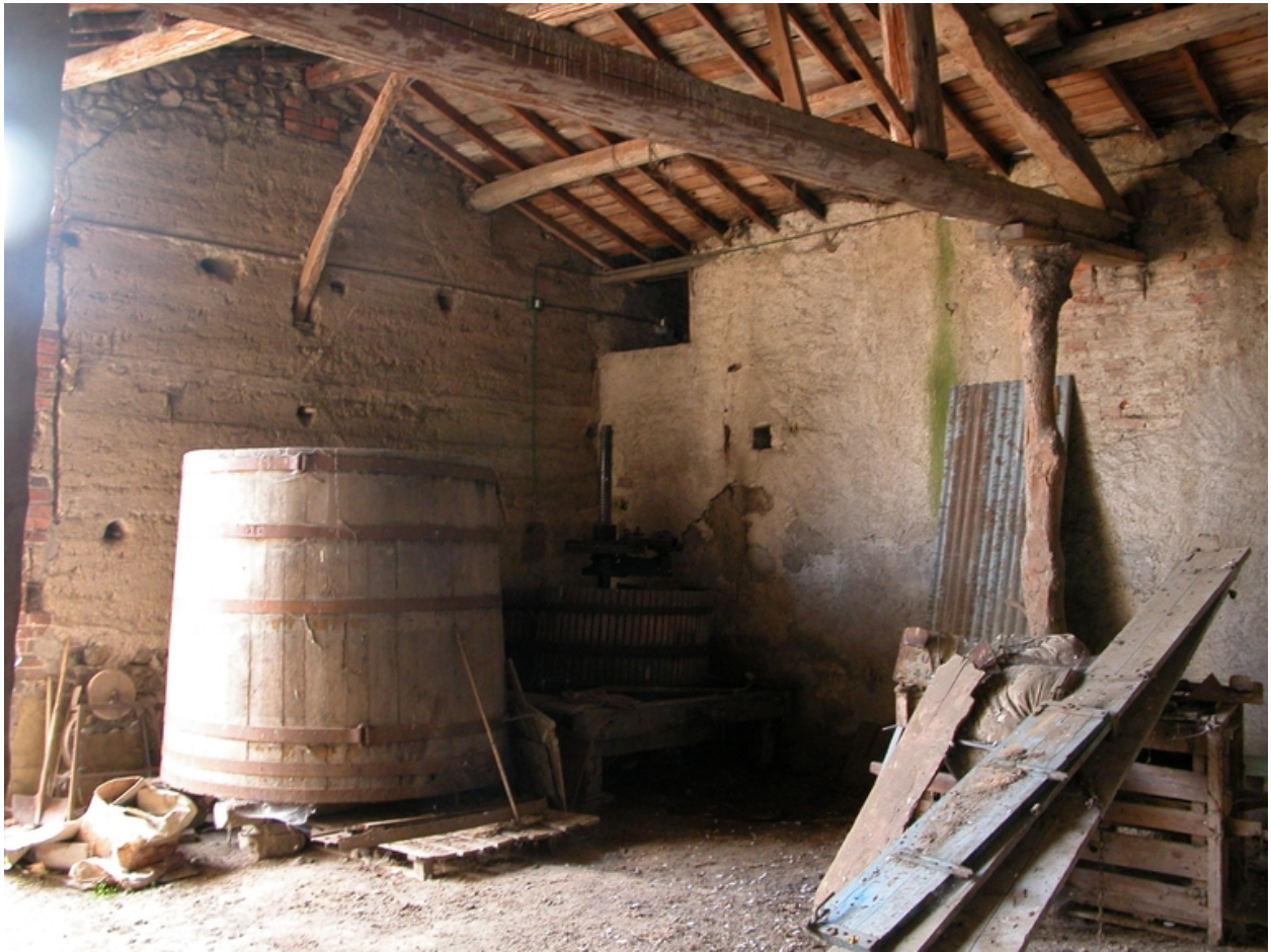
Vue intérieure du cuvage.
