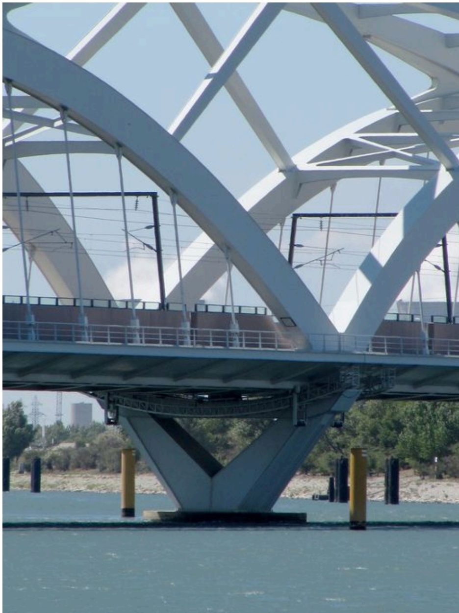
Arcs, face amont, vue partielle : jonction au-dessus de la pile centrale (depuis la rive gauche)
